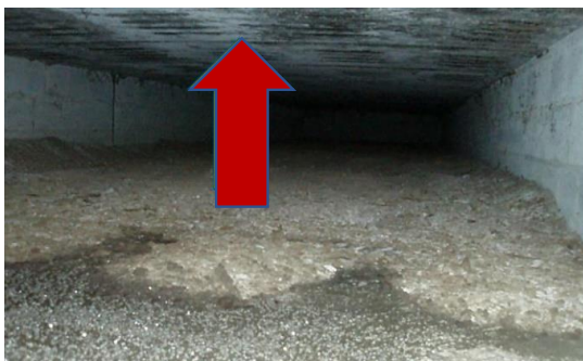
Abbildung 4 - Unterflurkanal mit losen Schmutzpartikeln und CIPC-Rückständen
